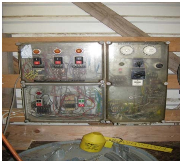
Рис.1. Центр управления зерносушилки
